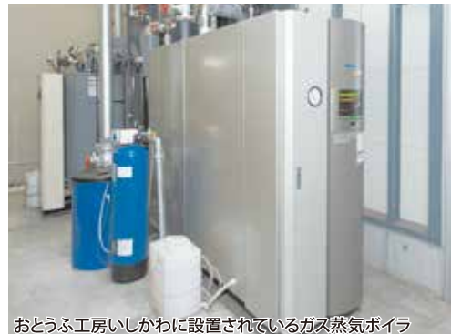
おとうふ工房いしかわに設置されているガス蒸気ボイラ
